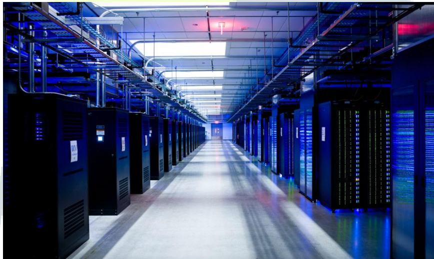
Aspecto interior de un centro de datos
